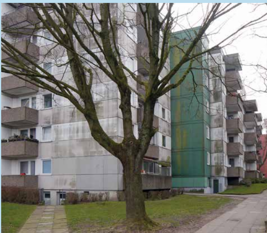
Häuser der Vonovia in Bielefeld-Sieker. In OWL hat dieses Unternehmen ca. 5.000 Wohnungen. Viele sind renovierungsbedürftig.
